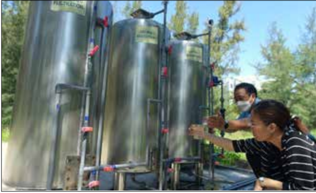
▲ Kiểm tra chất lượng nước thải sau xử lý trước khi tái sử dụng để tưới cây, điều hòa khí hậu tại một khu nghỉ dưỡng ở quận Ngũ Hành Sơn (Đà Nẵng)
