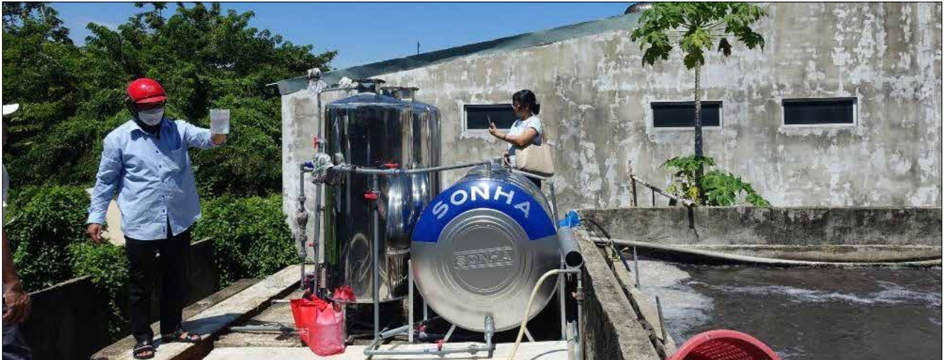
▲ Nước thải sau khi xử lý được kiểm tra đạt chuẩn sẽ được sử dụng để vệ sinh, tưới sà, làm mát nhà xưởng
