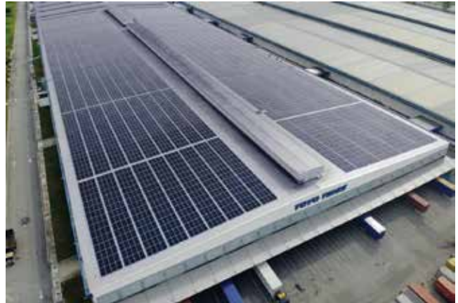
▲ Dự án quang điện mặt trời trên mái Nhà máy Toyo Tires do Tập đoàn Solarvest thực hiện tại Malaysia
