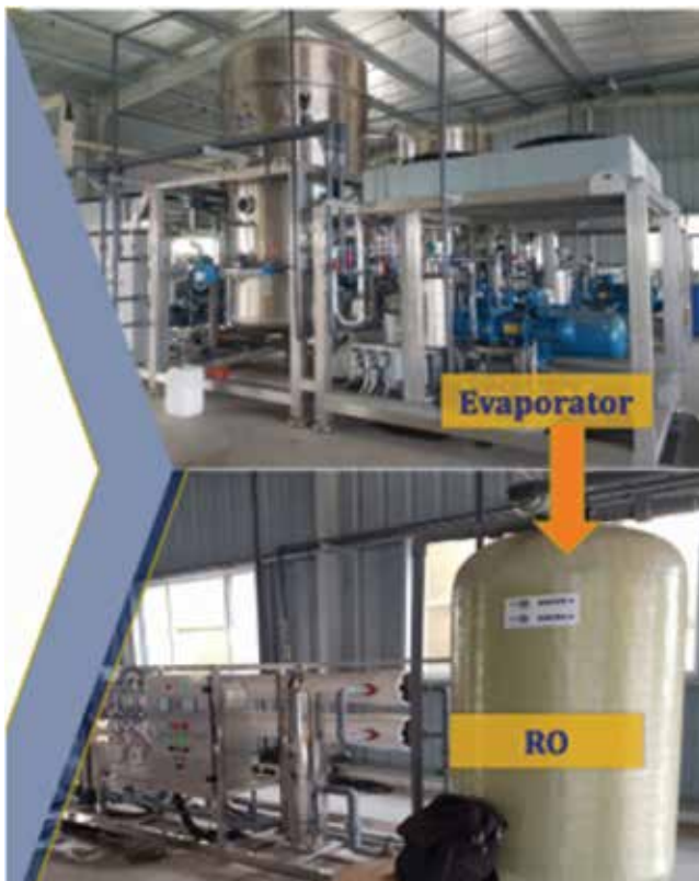
▲ Hình 2: Hệ thống tái chế nước thải dùng công nghệ hóa hơi kết hợp với màng RO tại một nhà máy xi mạ
